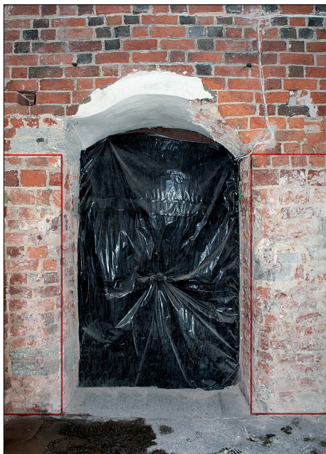
Il. 20. Kruchta północna kościoła Świętojakubskiego, portal od strony północnej. Widoczne ślady wykucia po oczyszczeniu z tynku w czasie remontu w 2009 r. Zaznaczono powierzchnię skutego cokołu.
