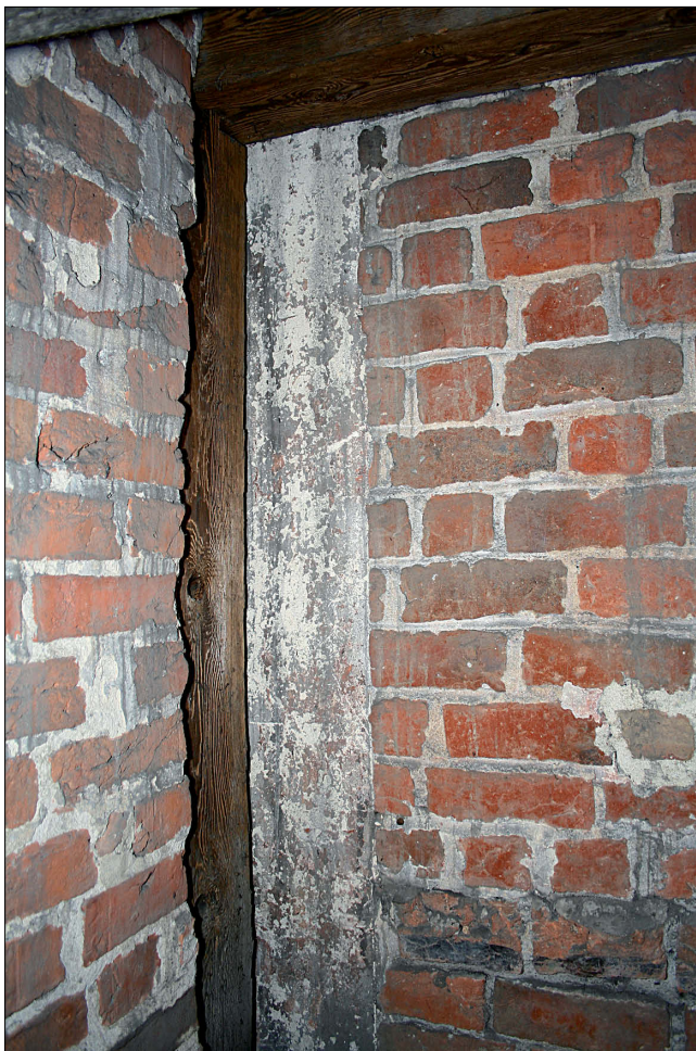
Il. 3. Poddasze kaplicy Ogrójca, fragment malowidła ściennego przesłonięty słupem drewnianej konstrukcji dachowej z 1508 r. i szczytem północnym. Fot. A. Konieczny, 2008 r.
