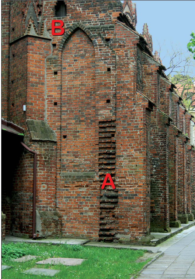
Il. 22. Kaplica Św. Rodziny, elewacja wschodnia: A – strzępia pozostawione na dowiązanie od wschodu planowanej kaplicy lub nowej zakrystii, B – opór sklepienny na planowane sklepienia.
