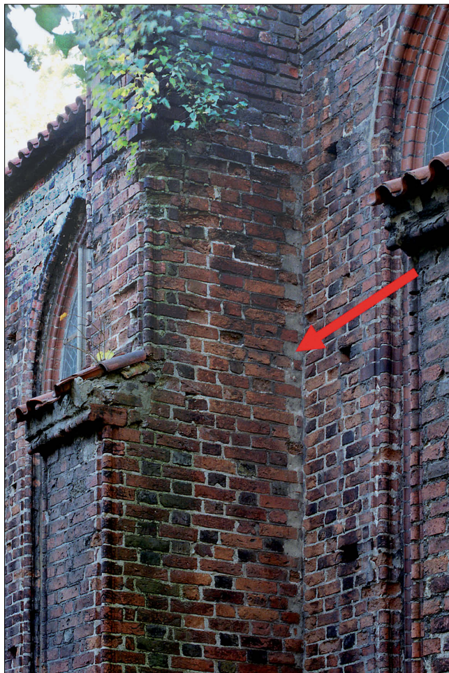
Il. 5. Kaplica Krzyża Św., strzępia cofnięte na szkarpie wschodniej, pozwalające na dowiązanie planowanej kaplicy sąsiedniej. Fot. A. Konieczny, 2004 r.
