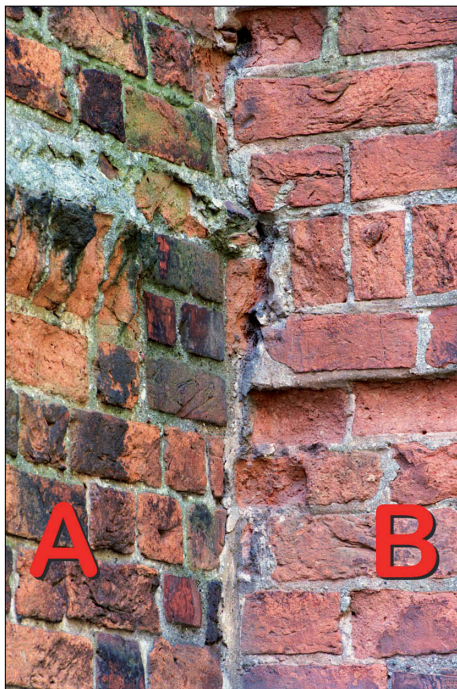
Il. 10. Kaplica św. Anny. Szkarpa wschodnia bez strzępi na dowiązanie ściany kaplicy sąsiedniej: A – szkarpa wschodnia kaplicy św. Anny, B – ściana południowa kaplicy św. Walentego. Fot. A. Koniczny, 2004 r.
