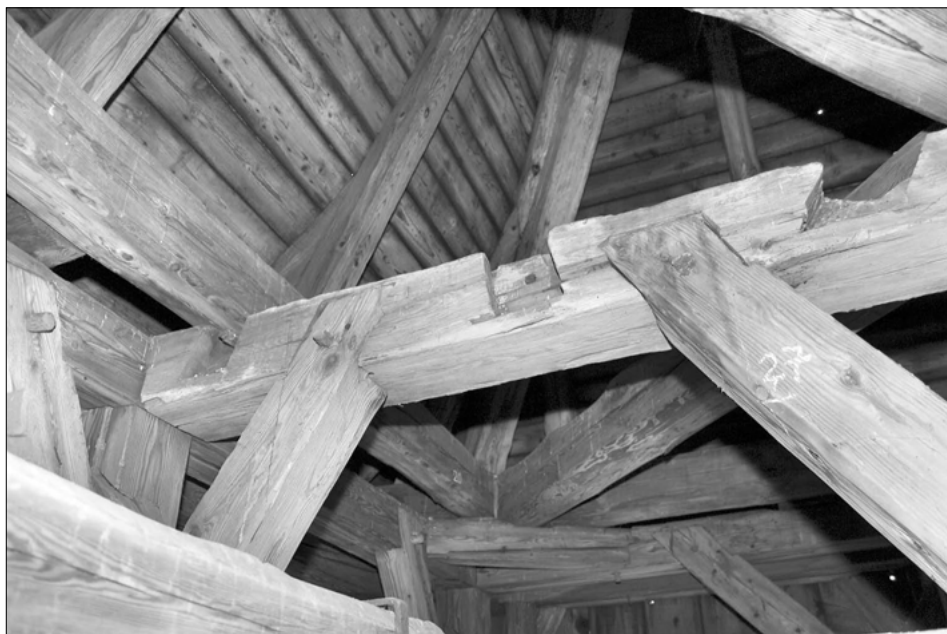
Il. 6. Gliwice-Ostropa, dawny kościół parafialny pw. św. Jerzego, wieża. Oczep środkowy izbicy z widocznymi gniazdami po złączach ciesielskich pierwotnej konstrukcji dachu wieży. Fot. A. Konieczny 2009
