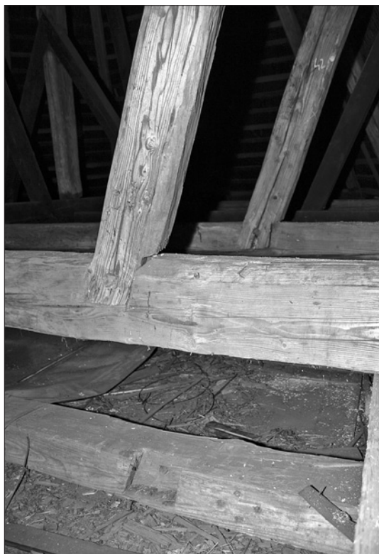
Il. 4. Sieroty, kościół parafialny pw. Wszystkich Świętych. Więźba dachowa nad prezbiterium. IV od zachodu wiązar, strona południowa w widoku od zachodu. Dołem widoczna oryginalna belka wiązarowa z 1427 r. (ze znakiem montażowym), górą wtórna belka z czasu podwyższenia więźby w 1544 r., połączona z oryginalnym mieczem stropowym. Fot. A. Konieczny 2008
