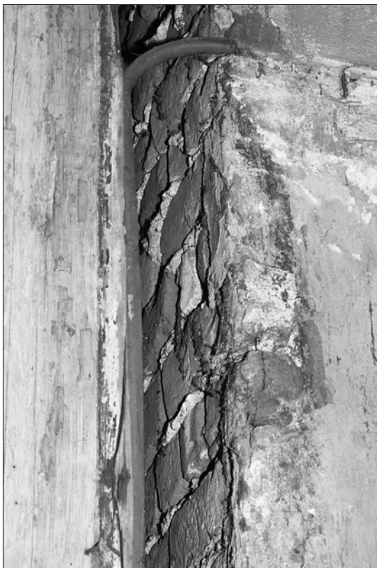
Il. 1. Gliwice-Ostropa, dawny kościół parafialny pw. św. Jerzego, styk murowanej ściany tęczowej prezbiterium ze wschodnią ścianą drewnianej nawy po stronie północnej. Widoczny brak opracowania lica muru prezbiterium, świadczący o jednoczesnej budowie prezbiterium i nawy. Fot. A. Konieczny 2008
